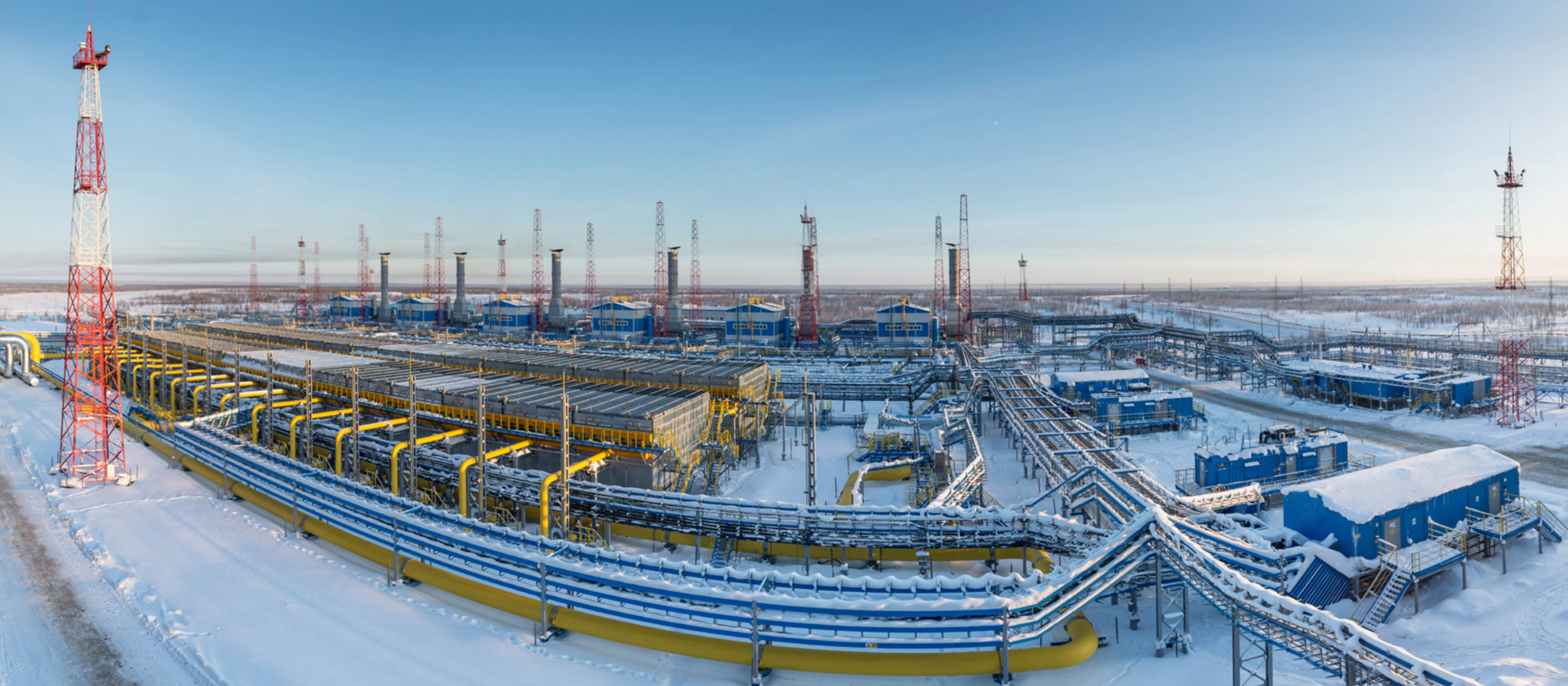
УСТАНОВКА КОМПЛЕКСНОЙ ПОДГОТОВКИ ГАЗА №3С, ЗАПОЛЯРНОГО НЕФТЕГАЗОКОНДЕНСАТНОГО МЕСТОРОЖДЕНИЯ
