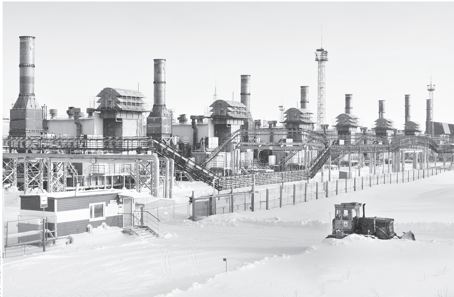
Вид на дожимную компрессорную станцию УКПГ-1В.
