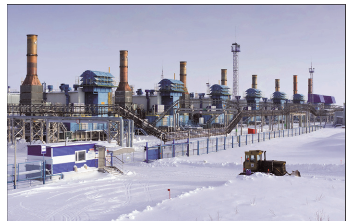
Вид на дожимную компрессорную станцию.
